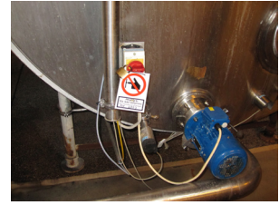
Skiltning om LOCK OUT. Afbryderen til maskinen er slukket og der er sat hængelås i.
