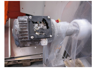
El-installationerne må ikke være ødelagte.
