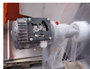
El-installationerne må ikke være ødelagte.
