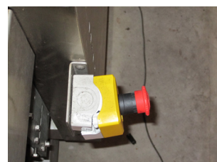
Det er ikke sikkert at et defekt nødstop virker, når man har brug for det!
