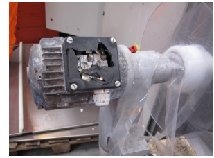
El-installationerne må ikke være ødelagte.
