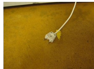
Stik uden jord og med beskadiget plastickappe
